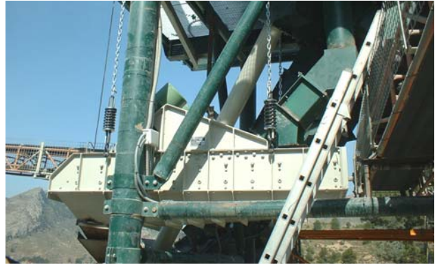
Tamices accionados por dos moto-vibradores.
