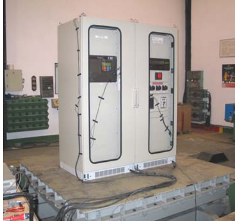
Panel de Protección de GENERAL ELECTRIC.
