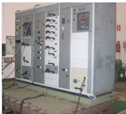
Armario eléctrico de ABB SYSTEMES BT.
