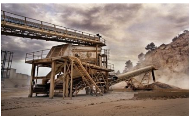
Instalación con criba de malla elástica para la separación de estériles a 7 mm y con capacidad de 170 Tn/h
